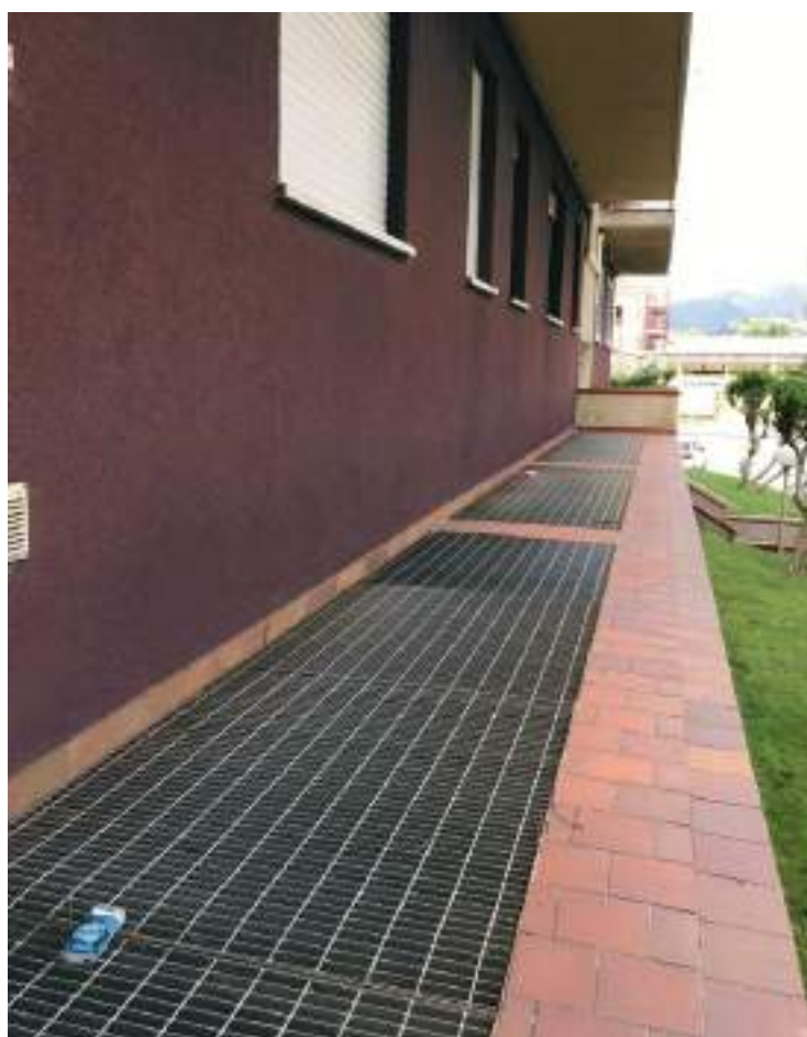
GRIGLIE DI AERAZIONE DELL'AUTORIMESSA
